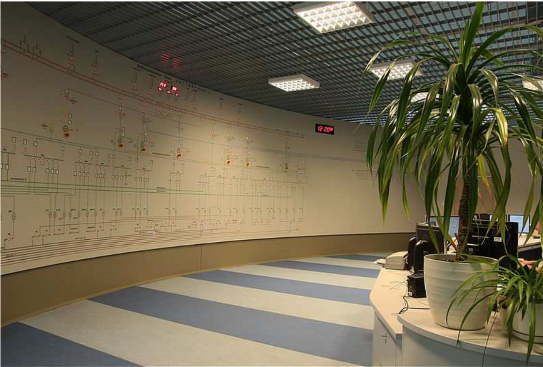
Widok na tablicę mozaikową w modernizowanej nastawni.
